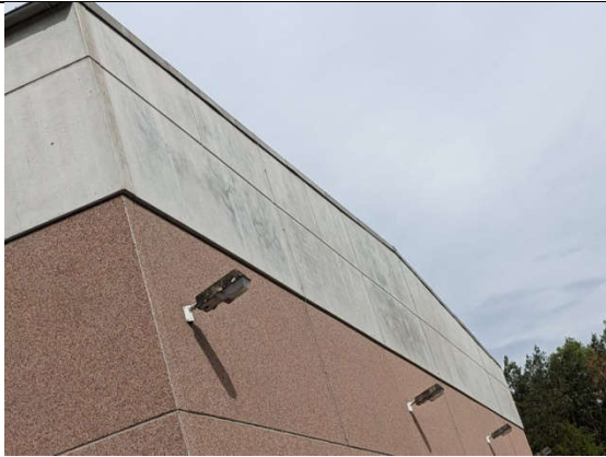
Foto Nr. 9: Ostseite des Ware House mit tw. abstehender Blechkante am Dachtrauf (Ortgang) – auch hier befindet sich ein Fledermausquartier...
