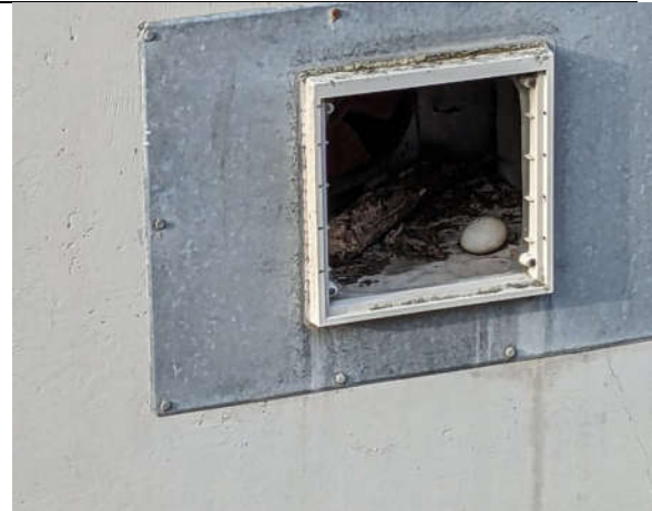
Foto Nr. 6: Brutversuch (vermutl. einer Taube) im Frühjahr 2025 im Lüftungsschacht über dem Kellerabgang.
